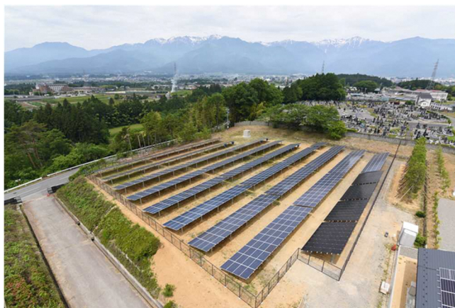
図表 56 リユース品を使用した発電所
