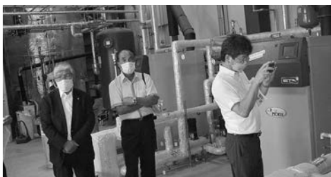
モデルタウン内のバイオマスボイラ設備
