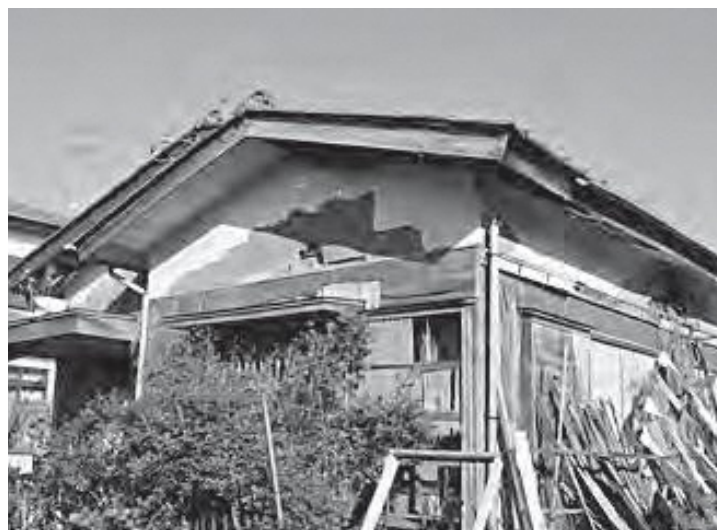
放置された空き家
