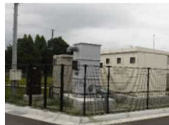
⑤非常用発電機 （ディーゼル）
