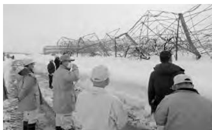
豪雪により被害を受けた連棟ハウス（八反）
