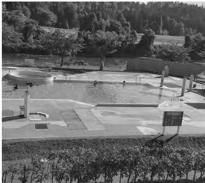
タイルの損傷が激しいクアハウス基点のスパプール
