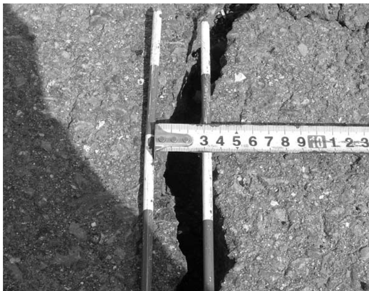
震災による道路の亀裂
