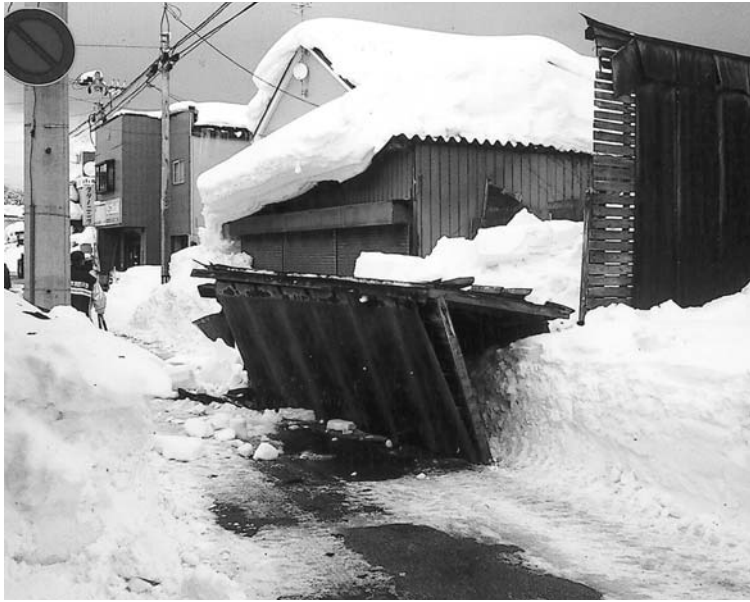
道路をふさぐ倒壊した家屋
